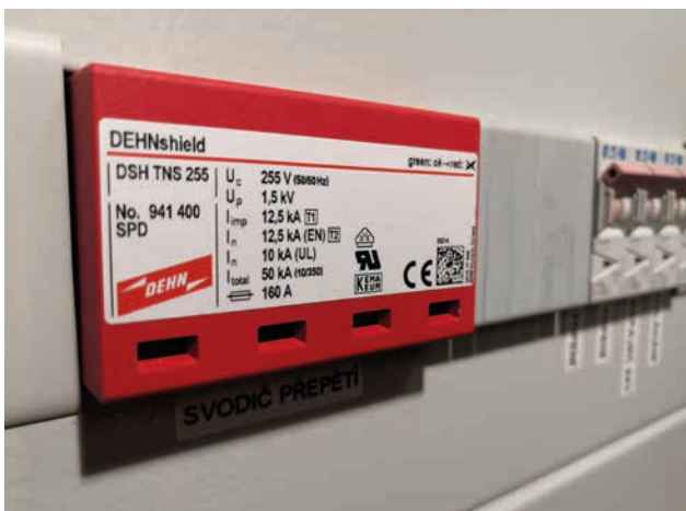
Podružné rozváděče Svodič SPD T1+T2+T3 (jiskřiště, 50 kA, vlny 10/350)
