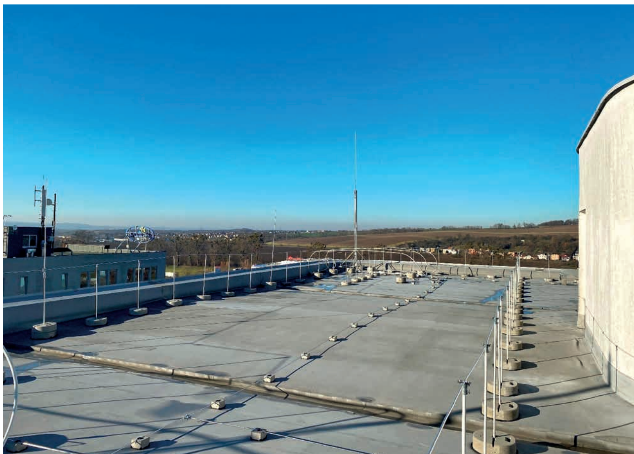
Pohled na LPS na vyšší budově Okresního soudu
